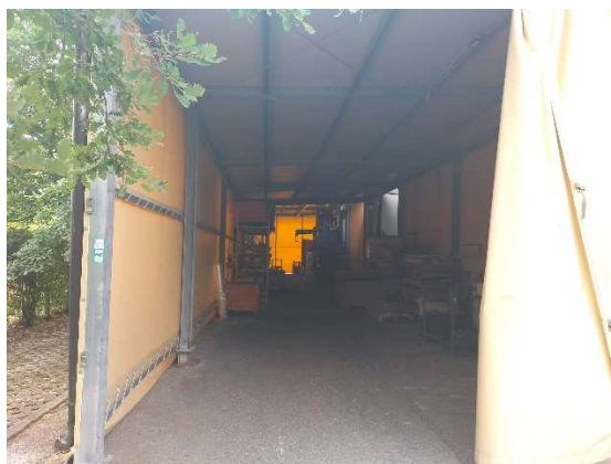
Porzione in ampliamento non autorizzata
